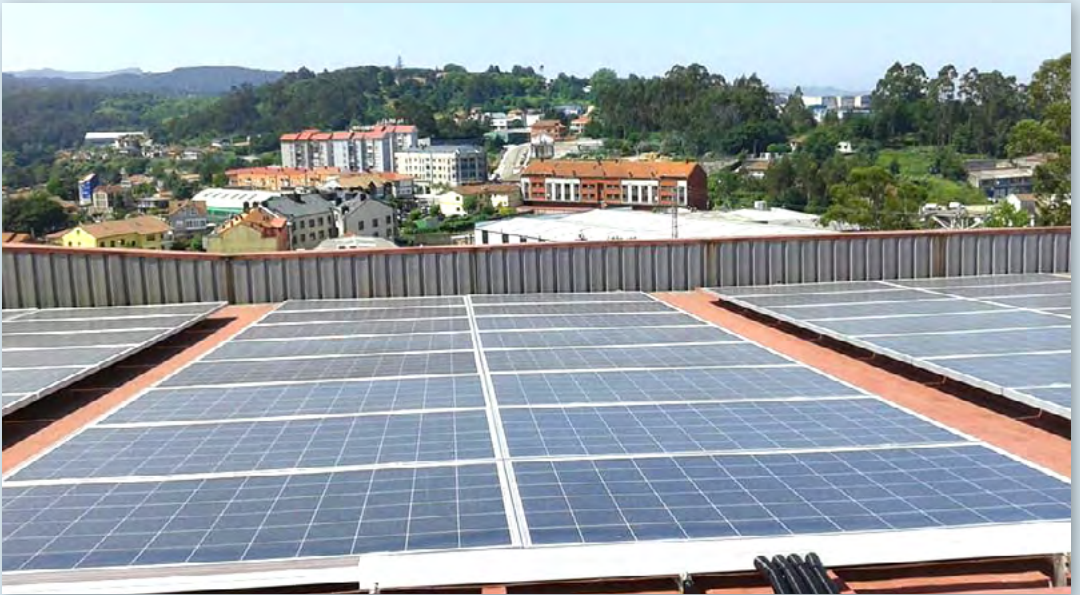
Instalación en la "Nave de Coregal", propiedad de la Comunidade de Montes Veciñais en Mán Común (CMVMC) de Tameiga. Con el acompañamiento de Nosa Enerxía y la colaboración de Montaxes Lagoa.
