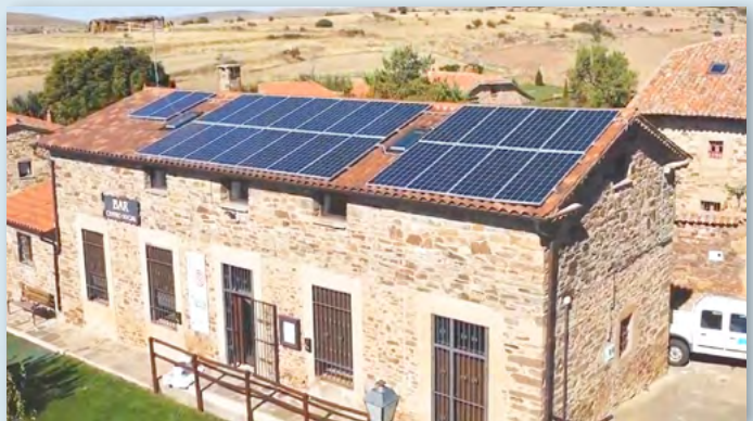
Instalación fotovoltaica en el Centro Social de Castilfrío de la Sierra.
