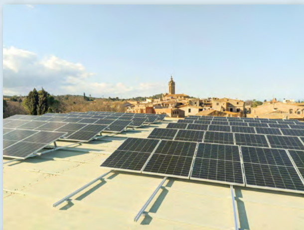
Instalación en la cubierta del polideportivo con una potencia en primera fase del proyecto, de 32 kWp ampliables.
