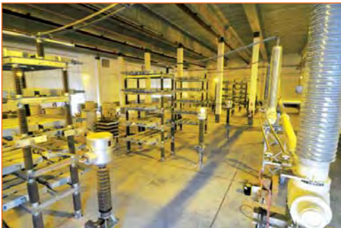
Interior de la estación convertora de Santa Ponsa.
