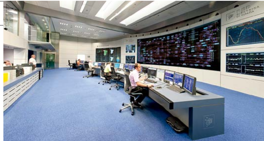
Sala central del Centro de Control Eléctrico (Cecoe), ubicada en Madrid.
