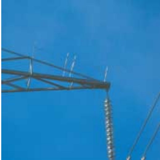
Modelo de utilidad: dispositivo disuasor de nidificación para apoyo de líneas eléctricas
