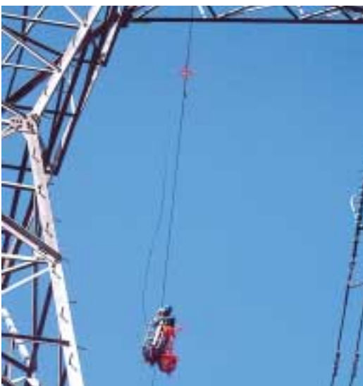
Señalización de línea con espirales salvapájaros
