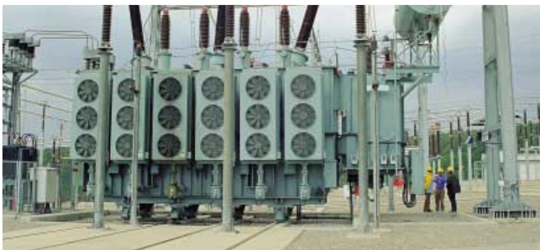
Transformador de potencia de 400 kV a 110 kV con foso de recogida de aceite. Subestación Calders.
