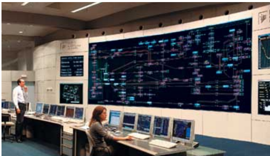
Instalaciones de CECOEL
