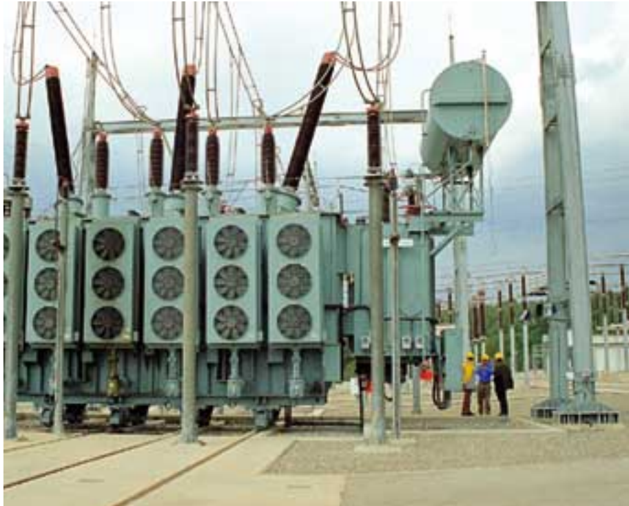
Transformador de potencia de 400 kV a 110 kV con foso de recogida de aceite. Subestación Calders.
