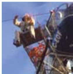
Señalización de la línea Gurrea-Sabiñánigo a su paso por la ZEPA "La Sotonera".
