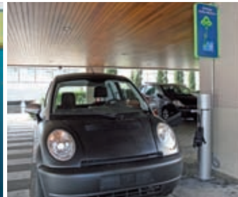
Punto de recarga de coches eléctricos
