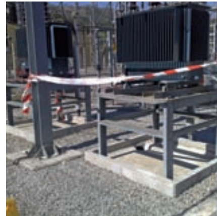
Cubetos de contención. SE Itxaso
